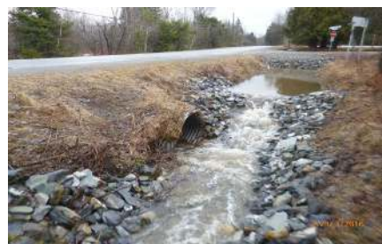
Fosse de dissipation sur le chemin de Mont-Bon-Plaisir
