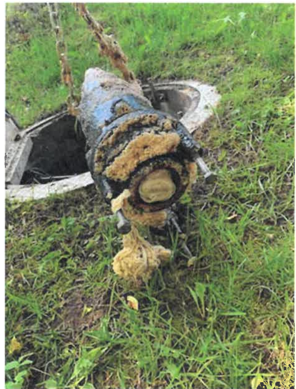
état de la canalisation
